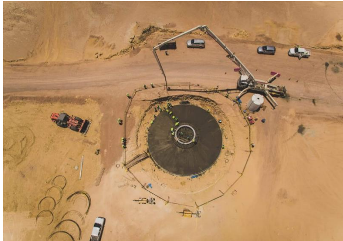
أعمال الأساسات الخرسانية بمحطة إنتاج الكهرباء بطاقة الرياح بقدرة 250 ميغاوات في رأس غارب بمصر
